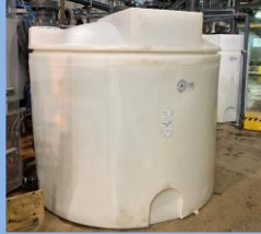
Installation chimique temporaire
